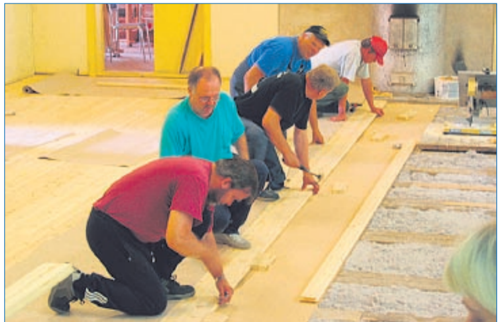
Remonttitaloissa laitettiin uusi lattia. Remontin vastaavana toimi Pekka Akkanen (etuala), muita työmiehiä olivat Juha Hörkkö, Jukka Koro, Tarmo Jytilä ja Vesa Pohjasmäki.
